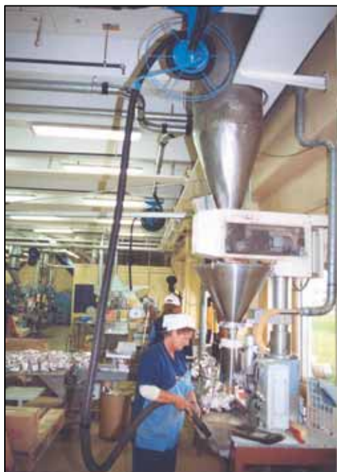
Centralt støvsugeanlæg, Danmark
