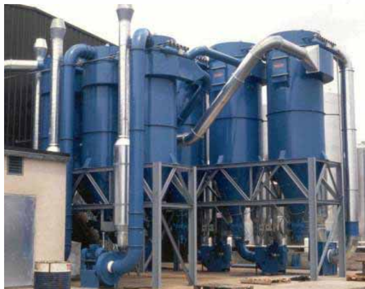
Filtres SimPact 4T pour récupérer des poussières de marbre, de verre et de polyester chez S.T.D. en France
